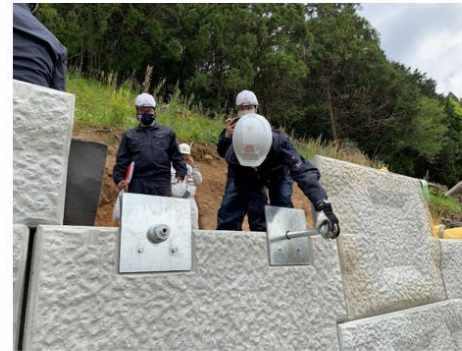
③ 支圧板類を壁面材前面に取付け ④ トルク鋼管類を支圧板に取付け
