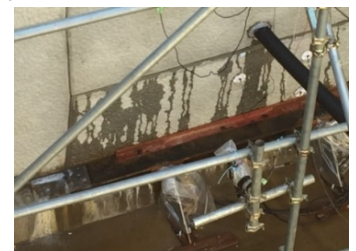
写真-4 壁面目地漏水状況 (試験終了，排水パイプ閉塞後 2 時間経過，背面給水停止中)
