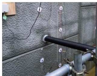
写真-3 壁面目地漏水状況 (排水パイプ開放後 2 時間経過，背面給水継続中)
