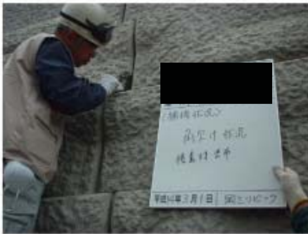
多数アンカー補修 角欠け 接着剤塗布
