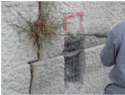
写真-1 壁面破砕状況
